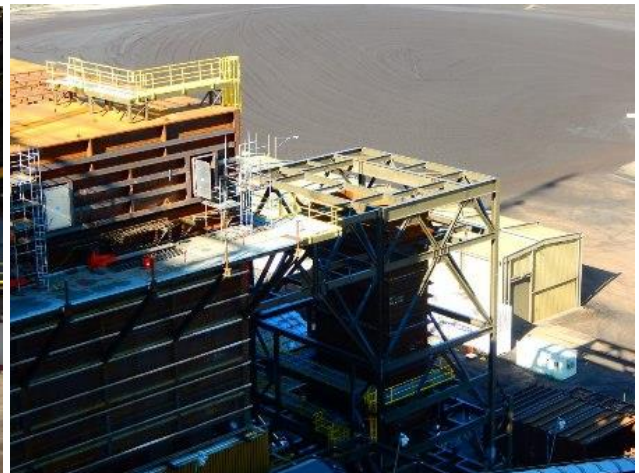
09-09 Corner of baghouse & 1A ID fan
