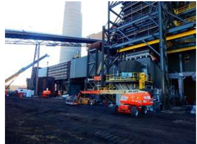
03-13 ID fan & ductwork to stack
