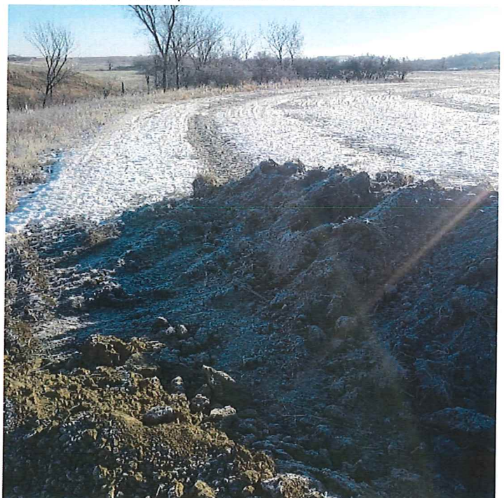
P2 - STA 7+26 Topsoil Windrow
